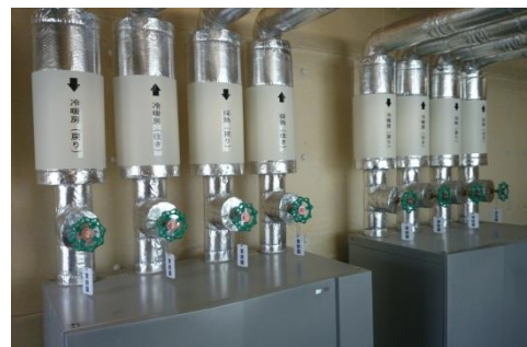
地中熱ヒートポンプ熱交換 設備
