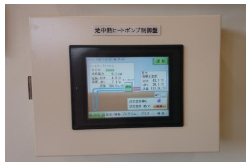
地中熱ヒートポンプ制御盤
