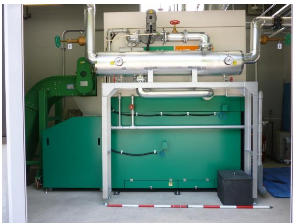
木質チップボイラー
