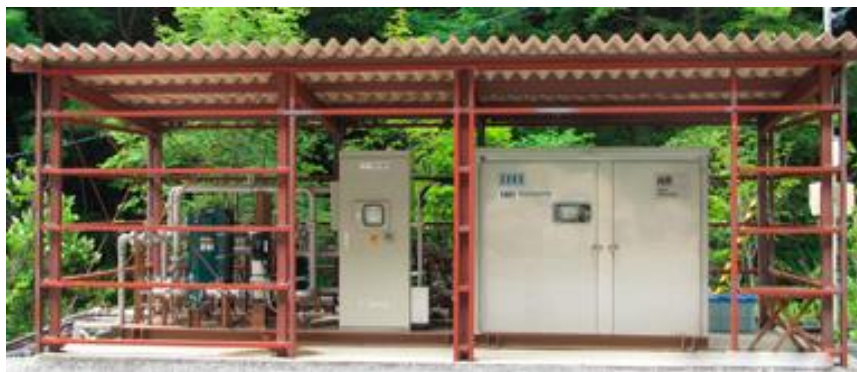
七味温泉ホテルに設置されたバイナリー発電設備
