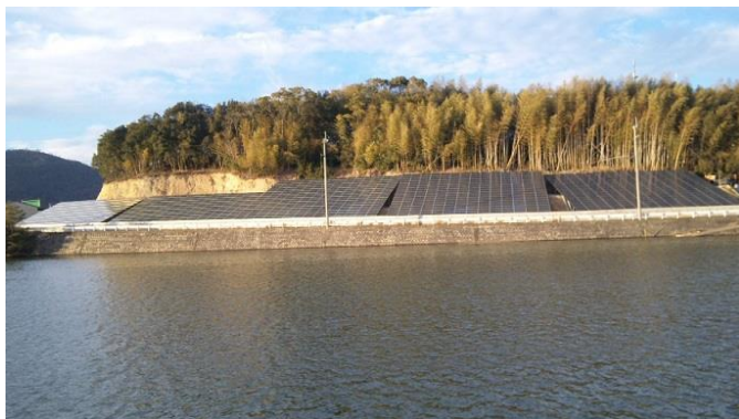
発電施設の外観
